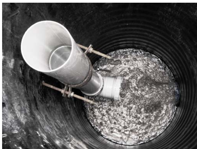
شکل ۲- جزئیات نصب سازه کنترل سطح ایستابی و سازه کنترل سطح ایستابی آماده بهره‌برداری
