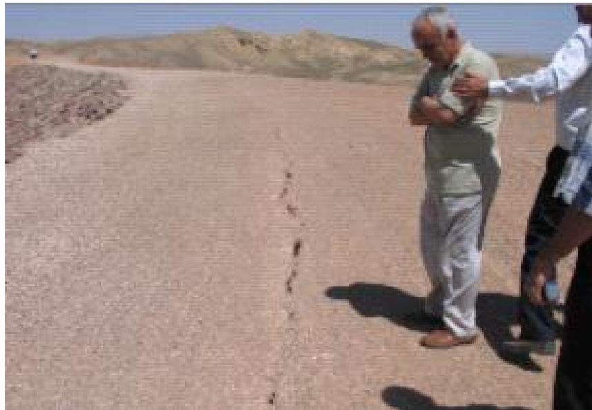
شکل ۲- ترک طولی روی تاج سد
